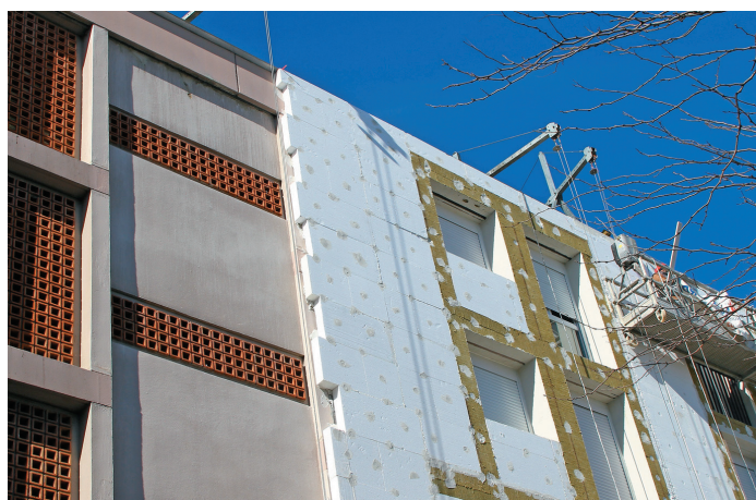
Pour réaliser une rénovation énergétique efficace, il faut effectuer auparavant un audit global de la copropriété.
